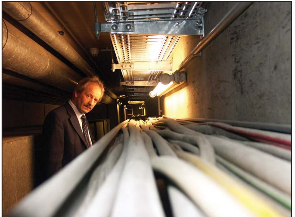
Nabelschnur des Gebäudes: Daniel Saelens erläutert Kabeltrassen im dritten Untergeschoss. Hier laufen Strom und Datenkabel ins A-Gebäude. Foto: Kalcher
